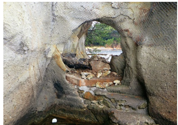
図2 トンネル崩落
