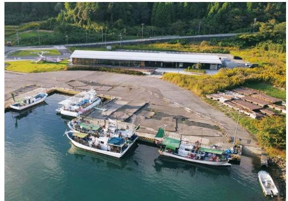
図8 つくモール近傍の岸壁損傷（2024年2月1日撮影）
