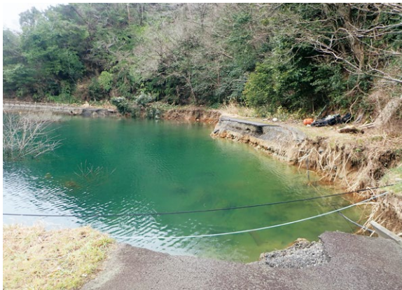
図6 九十九湾探勝歩道（ホテルのときんぶら下）の道路崩落（2024年4月22日撮影）
