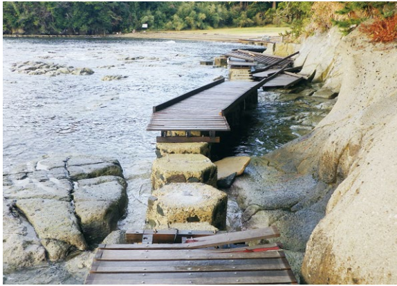
図4 ボードウォーク破損
