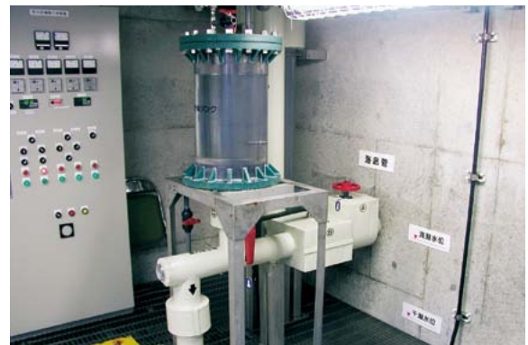
写真2 気液分離タンク
