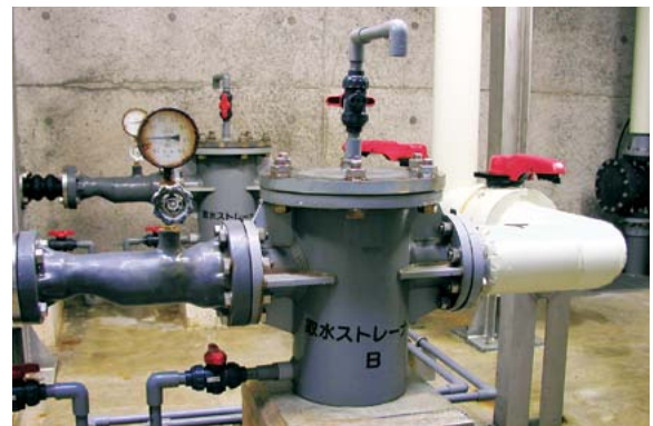
写真3 取水ストレーナー
