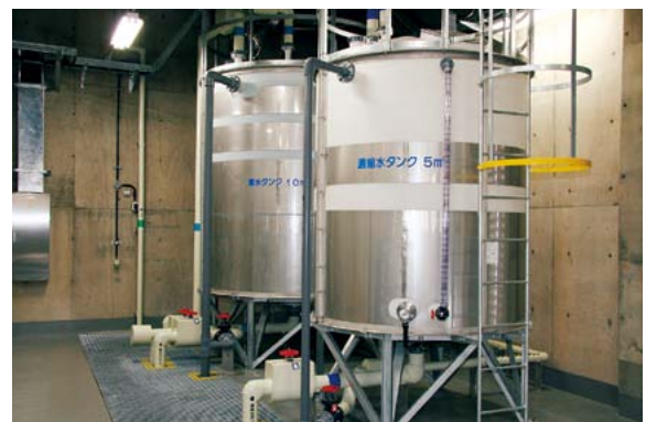
写真4 原水タンク（奥）と濃縮水タンク（手前）
