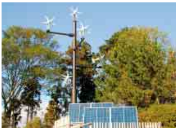
太陽の光と風を利用するハイブリッド式発電機
